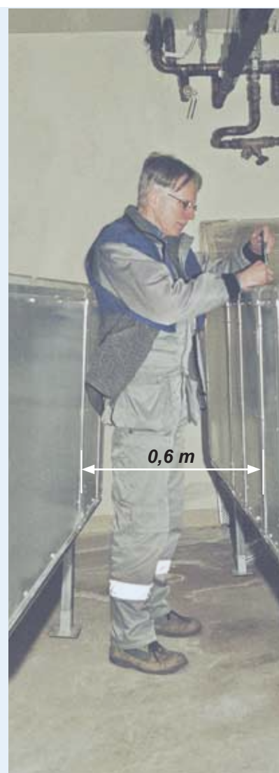
Mellan två apparater krävs en bredd av minst 0,6 m för att en person ska kunna passera. Detta mått anger fritt utrymme. Annan utrustning, till exempel rör, ventiler eller termometrar får inte inkräkta på utrymmet.
